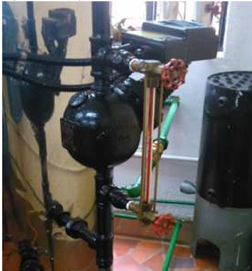
Figura 8. Bomba y controlador de nivel McDonnell 150s
