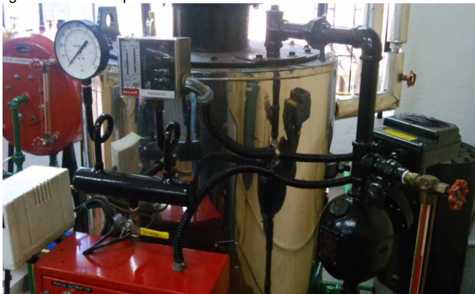
Figura 6. Caldera piro tubular de funcionamiento automático.
