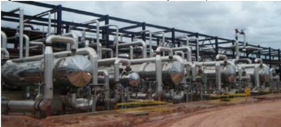
Figura 9. Intercambiadores de calor crudo - crudo y crudo - vapor
